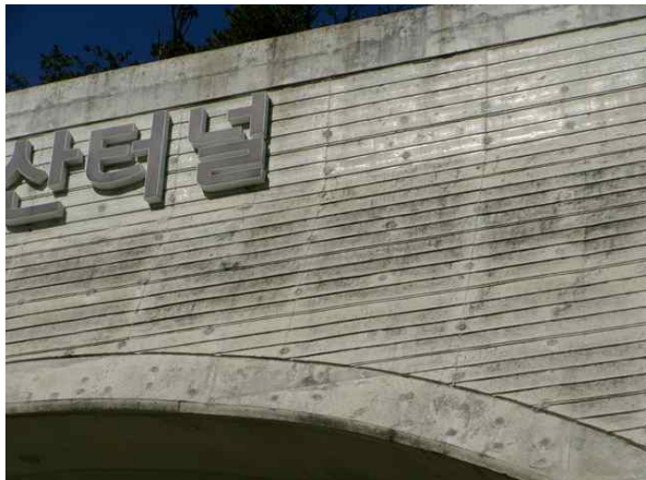
시점측 갭문 균열(Cw=0.3mm미만)-문산방향
