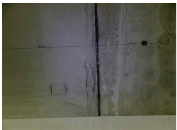
라이닝 S46 측벽부 균열부 백태-문산방향
