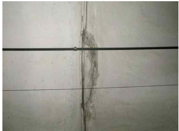
라이닝 S10 천단부 콘크리트 들뜸-서울방향
