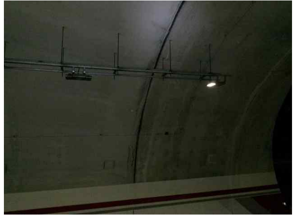
라이닝 S28 천단부 실링재 미시공-문산방향
