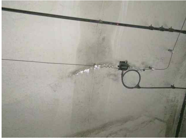
라이닝 S03 천단부 백태-문산방향
