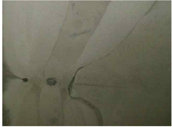
라이닝 S05 천단부 균열( Cw=0.3\text{mm} 이상)-서울방향
