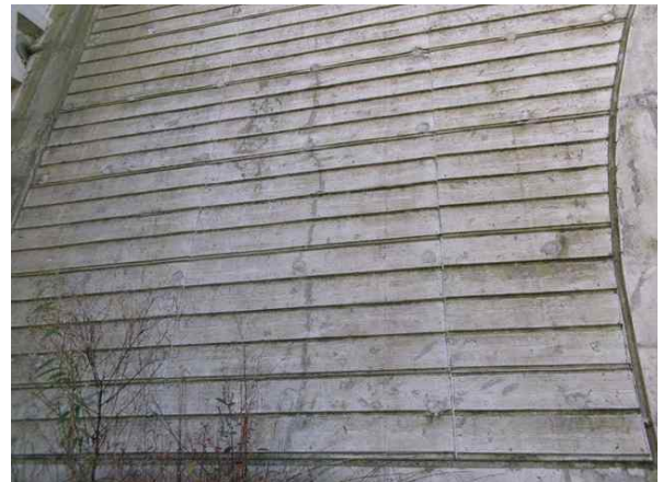
종점측 갭문 균열(Cw=0.3mm미만)-문산방향
