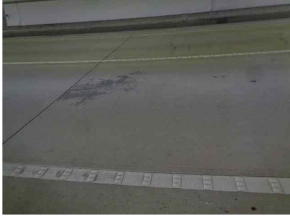
포장부 S04 망상균열-문산방향
